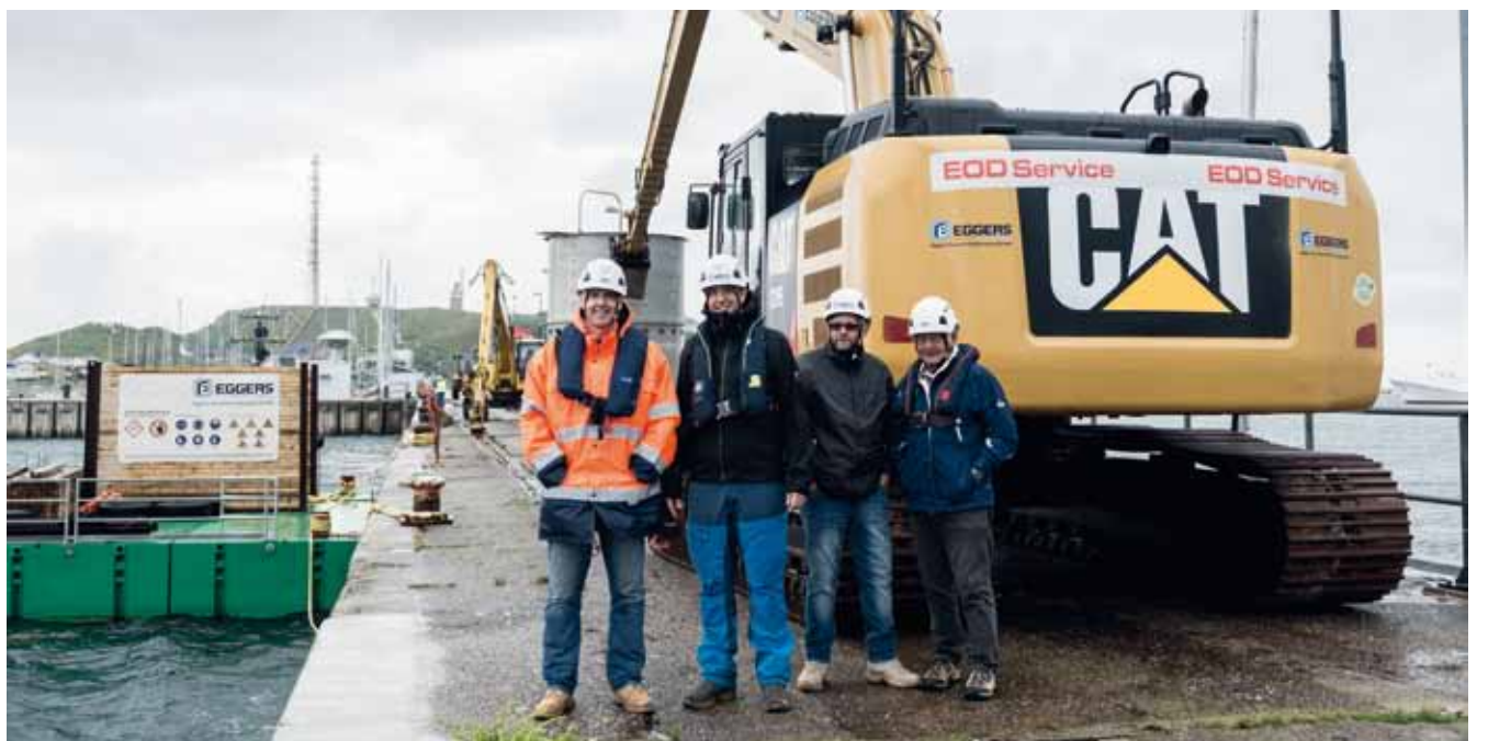
Mit kompletter Schutzausrüstung, zu der auch Schwimmwesten gehören: Leif Nebel (Zweiter von links), Geschäftsführer der Eggers Kampfmittelbergung, sowie Stefan Groos (links), Gebietsverkaufsleiter der Zeppelin Niederlassung Hamburg, die zusammen mit Mitarbeitern vor Ort, den Baumaschineneinsatz begutachten.
