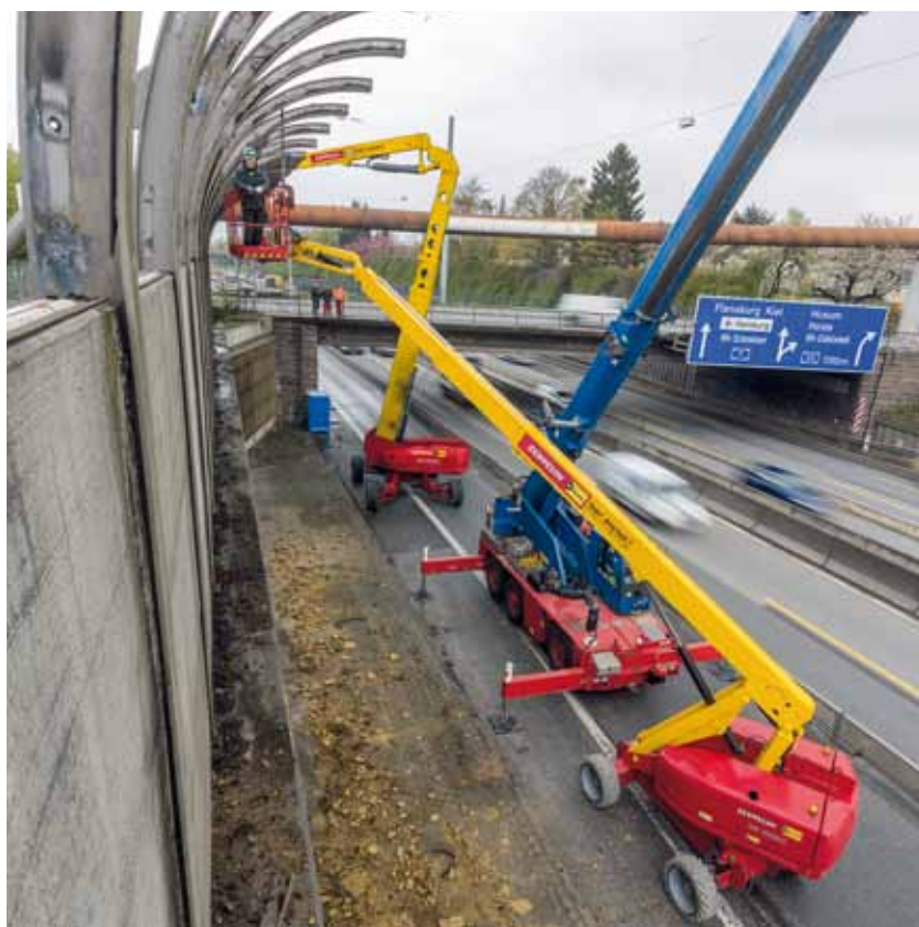
Vorbereitend zum Ausbau der A7 bei Hamburg unterstützten kürzlich zwei Arbeitsbühnen von Zeppelin Rental bei der Demontage von Lärmschutzwänden. Foto: x21de Reiner Freese
