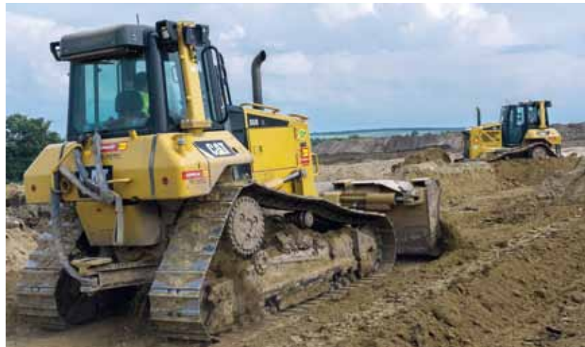
Zwei Dozer D6N aus dem Mietpark von Zeppelin Rental beim Neubau an der A5.
